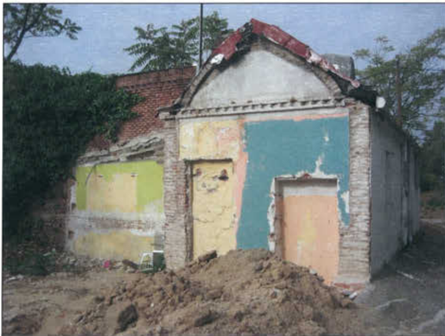
Figura 21 Ermita de Ntra. Sra. de Lourdes. Vivienda adosada en la parte posterior y vertidos clandestinos.
