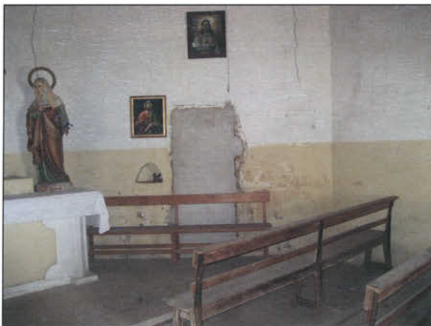
Figura 29: Ermita de San Roque. Puerta cegada
