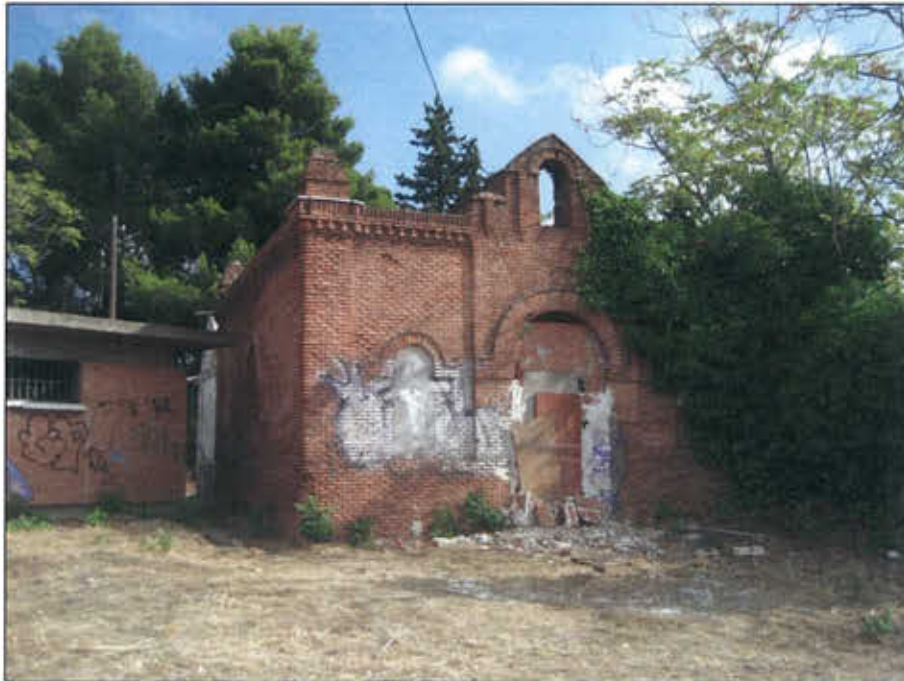
Figura 18 Fachada principal de la ermita de Ntra. Sra. de Lourdes, con graffitis y vegetación que la oculta parcialmente
