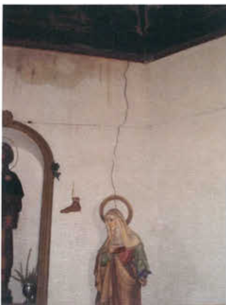
HUMEDADES EN EL MURO SITUADO AL ESTE, EN ENCUENTRO CON ZUNCHO DE CUBIERTA
