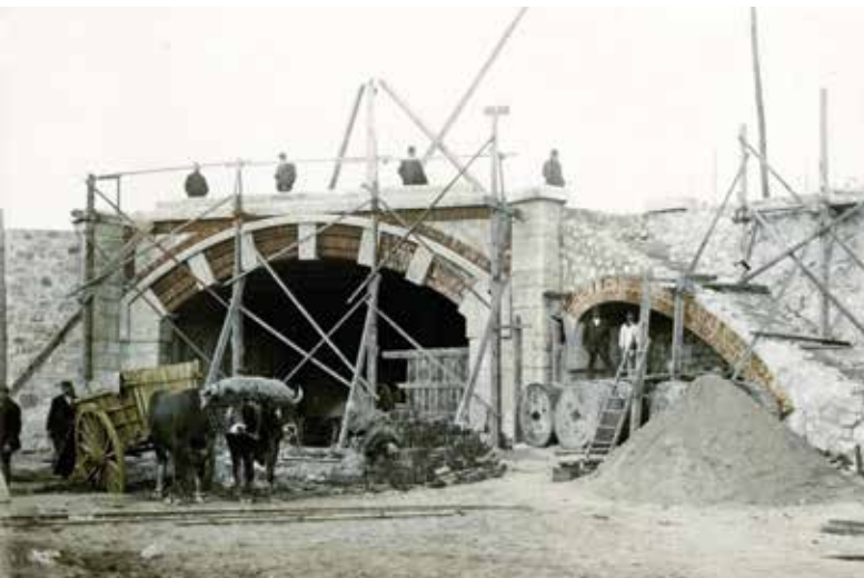
Embocadura del túnel de las cocheras en construcción, 1918. Archivo Cátedra de Estética, UPM.
