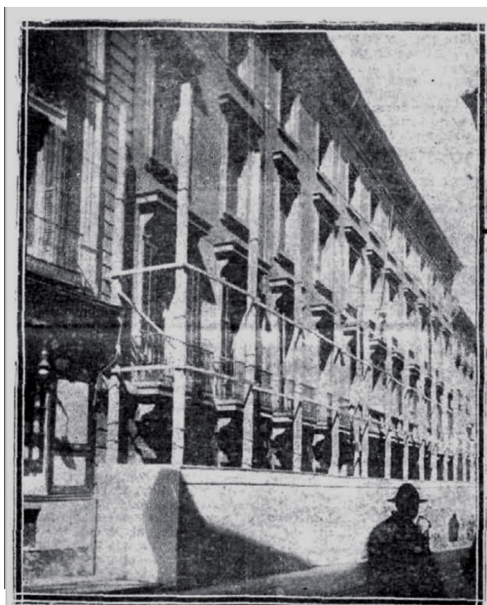
He aquí lo que queda en pie de la antigua Casa de Correos: su fachada principal, que muy en breve será demolida (Foto Pío.)
