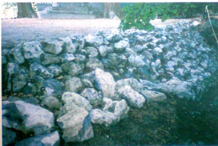
Muro de contención en la ría del jardín de El Capricho (Alameda de Osuna)
