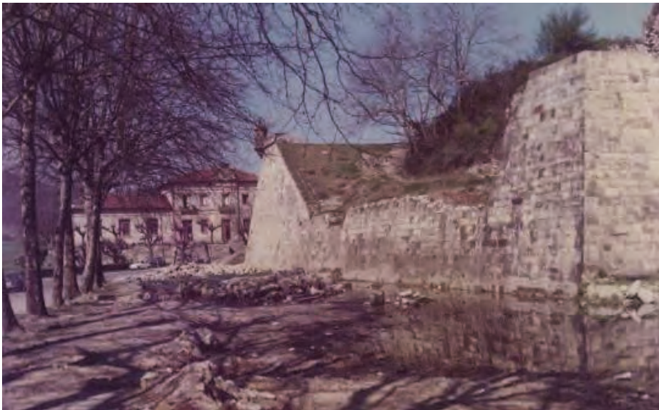
Baluarte de la Reina. Trabajos de restauración y mantenimiento. Foto: Archivo de la Diputación Foral de Gipuzkoa; Portal: Gure Gipuzkoa.
