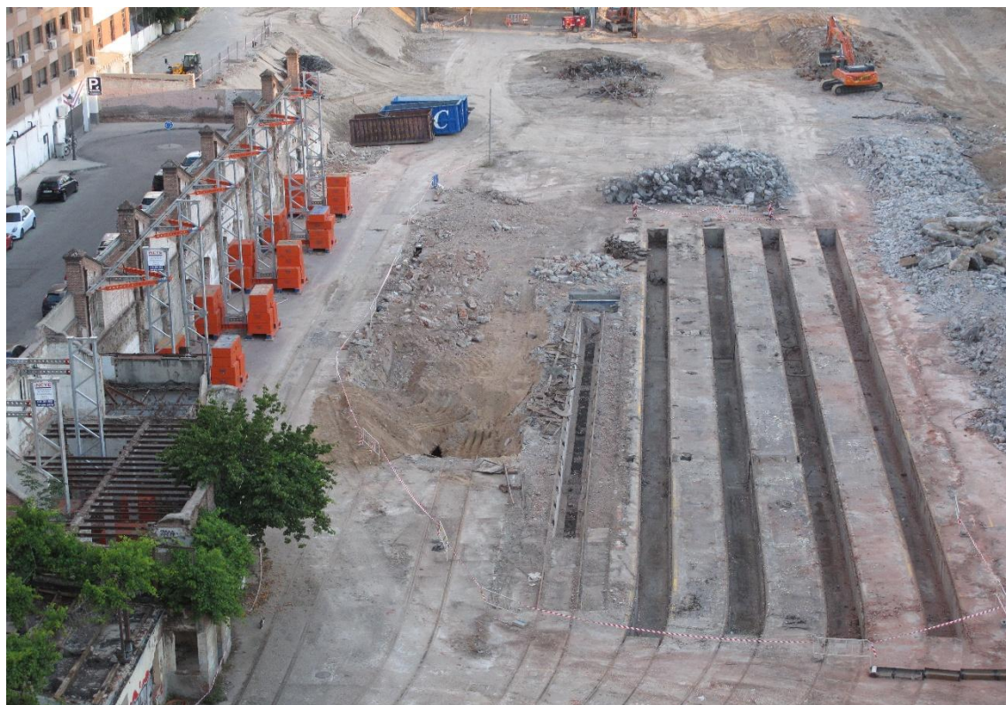
Estado de las Cocheras de Cuatro Caminos tras el derribo ilegal de sus naves en junio de 2021. MCyP.
